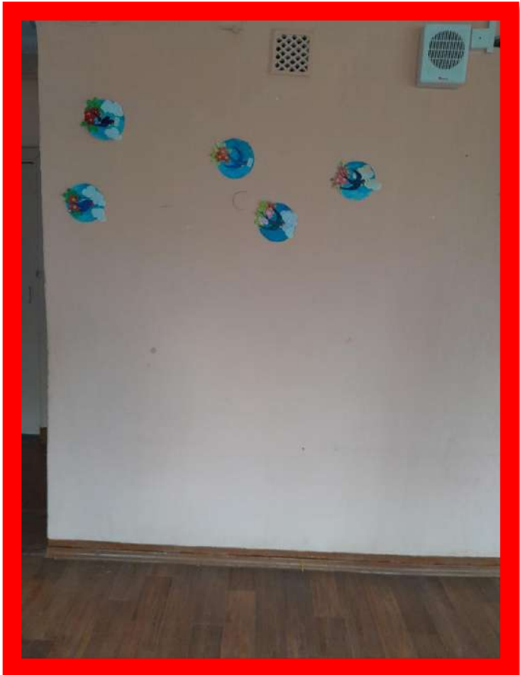
Отсутствие фонтанчиков на этажах
